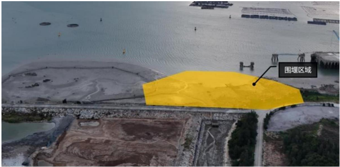
施工机械从破口位置进场，对围堰区域进行场地清理及整平；
